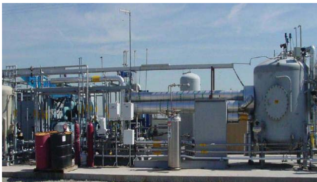
A small-scale LNG plant converts CMM into LNG at the Zory Coal Mine in Poland.
