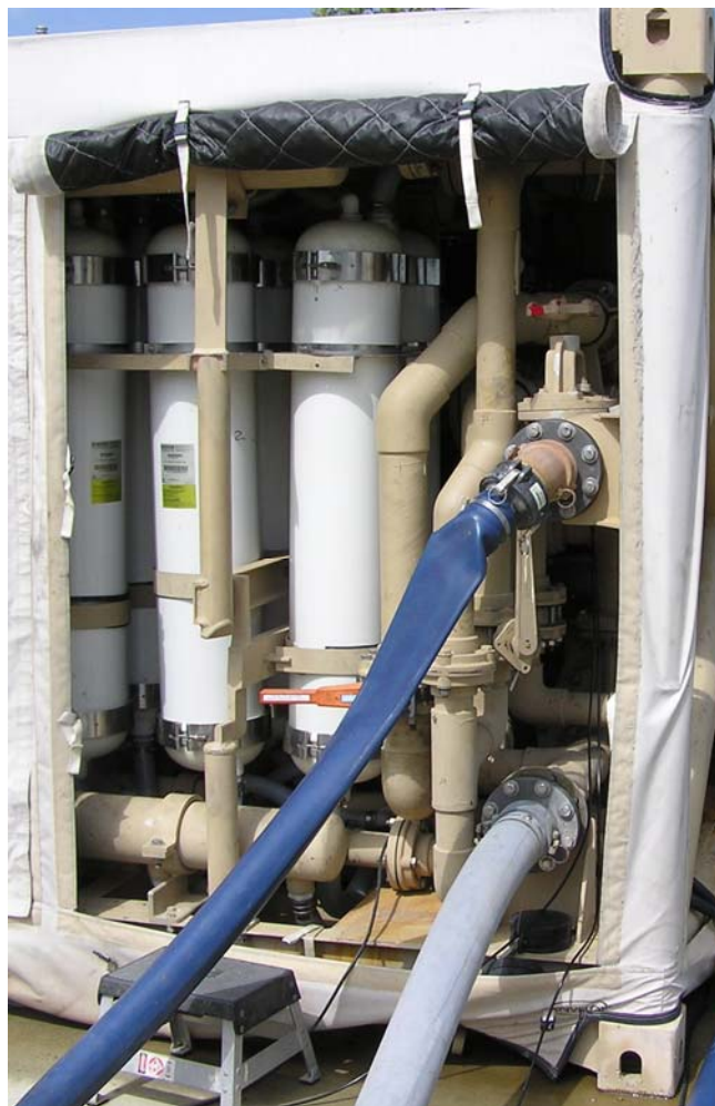
Figure 2-1. UF modules in the EUWP UF skid.
