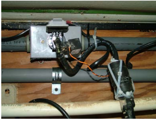
Fan runtime sensor
