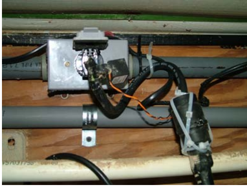
Fan runtime sensor
