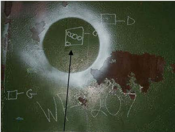
A-P36-1 GOUGE REPAIR
