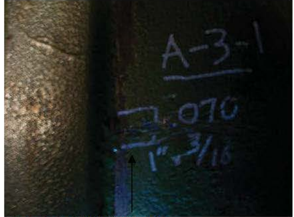
A-P3-1 GOUGE REPAIR
