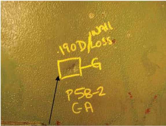
A-P58-2 GOUGE REPAIR
