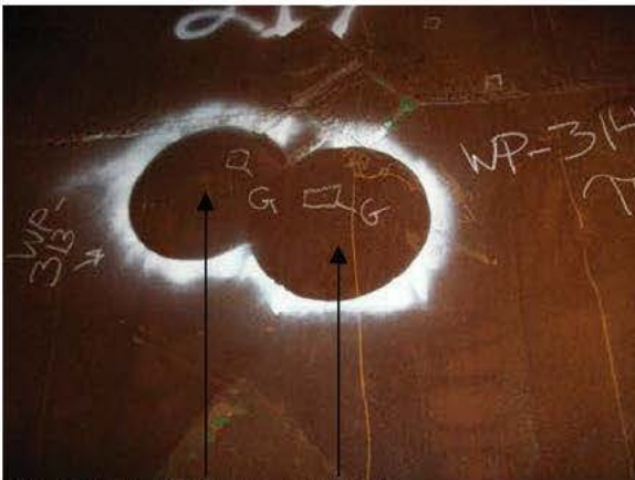
R20-P8-3 GOUGE REPAIR
