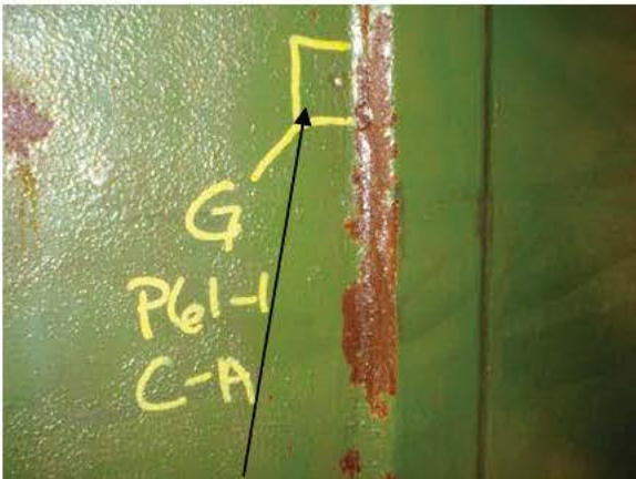
A-P61-1 GOUGE REPAIR
