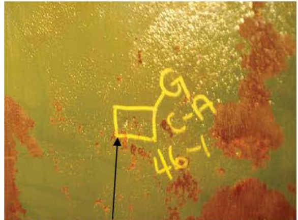
A-P46-1 GOUGE REPAIR
