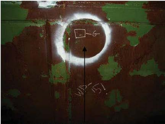
C-P38-1 GOUGE REPAIR
