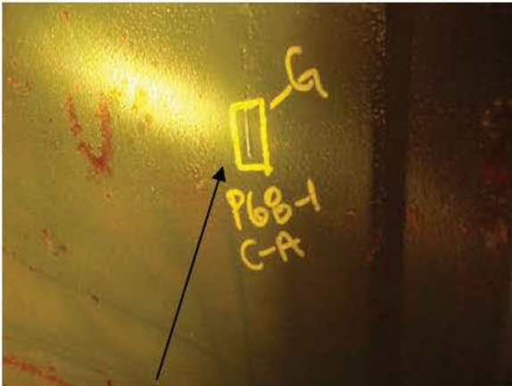
A-P68-1 GOUGE REPAIR
