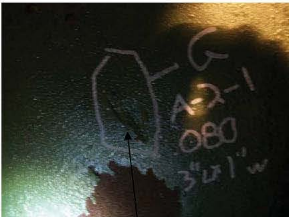
A-P1-2 GOUGE REPAIR
