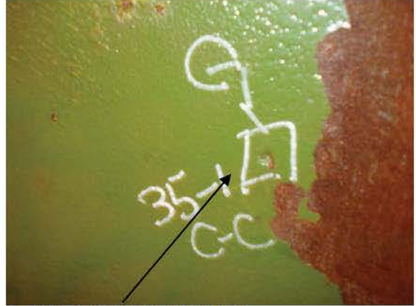
C-P35-1 GOUGE REPAIR
