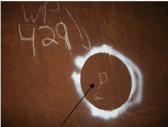
C3-P66-1 GOUGE REPAIR
