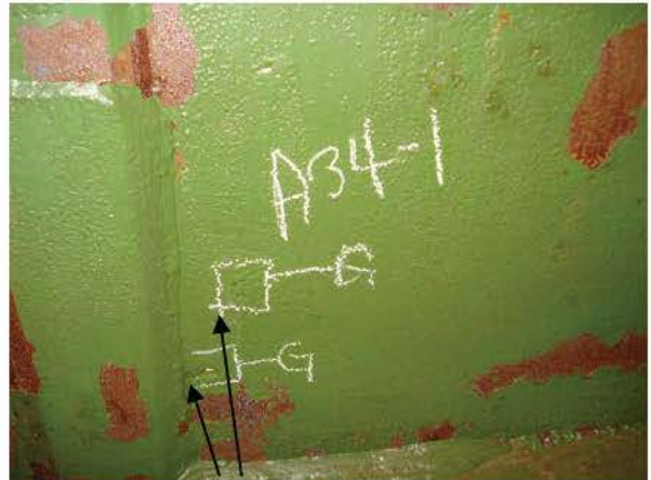
A-P34-1 GOUGE REPAIR
