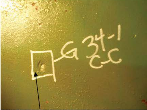
C-P34-1 GOUGE REPAIR
