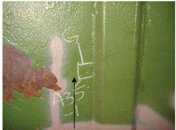
A-P35-1 GOUGE REPAIR
