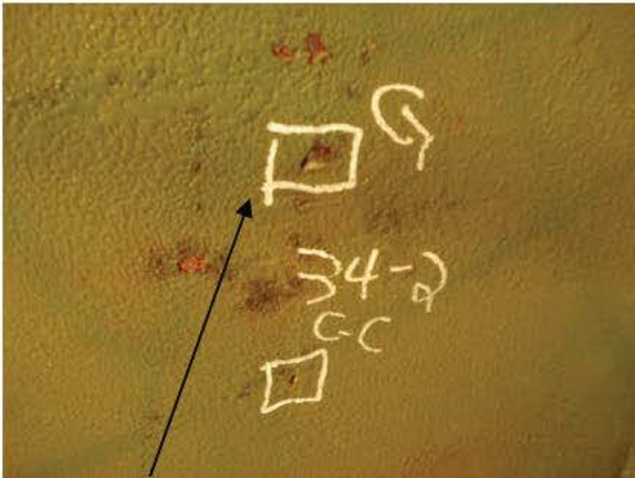
C-P34-2 GOUGE REPAIR
