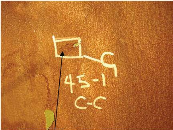
C-P45-1 GOUGE REPAIR
