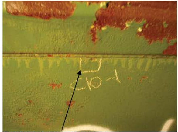
C-P10-1 GOUGE REPAIR
