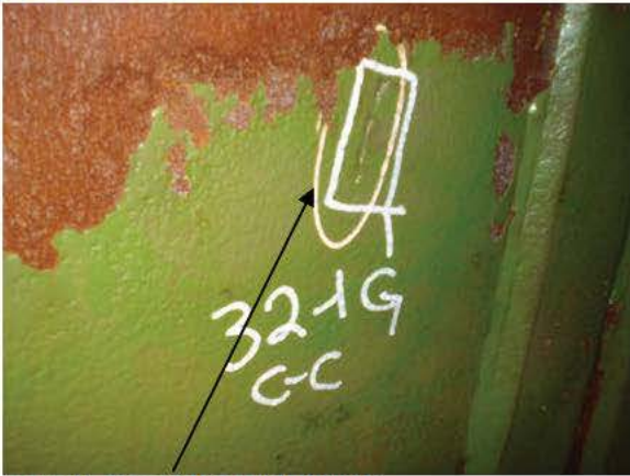
C-P32-1 GOUGE REPAIR
