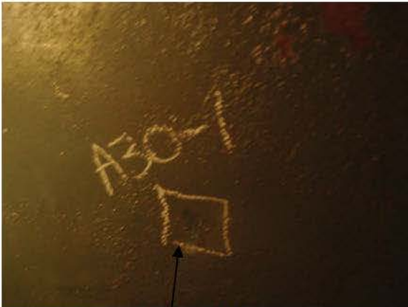
A-P30-1 GOUGE REPAIR
