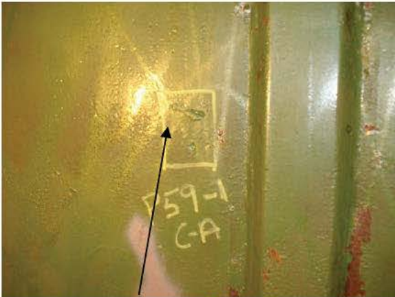
A-P59-1 GOUGE REPAIR
