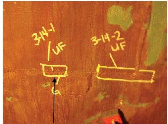
R3-P14-2 GOUGE REPAIR
