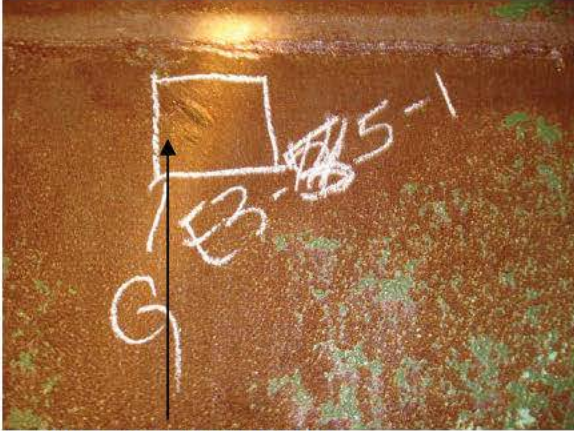
E3-P5-1 GOUGE REPAIR
