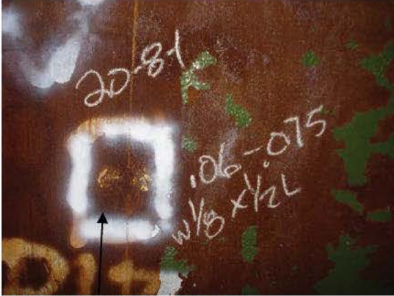
R20-P8-1 GOUGE REPAIR
