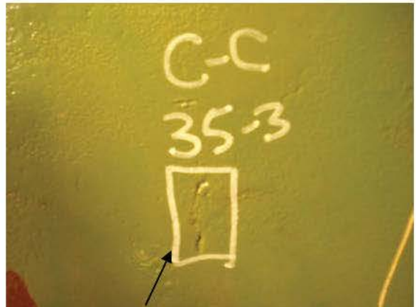
C-P35-3 GOUGE REPAIR
