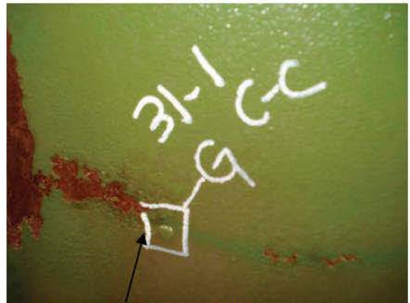
C-P31-1 GOUGE REPAIR
