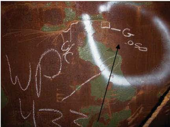
R1-P16-1 GOUGE REPAIR
