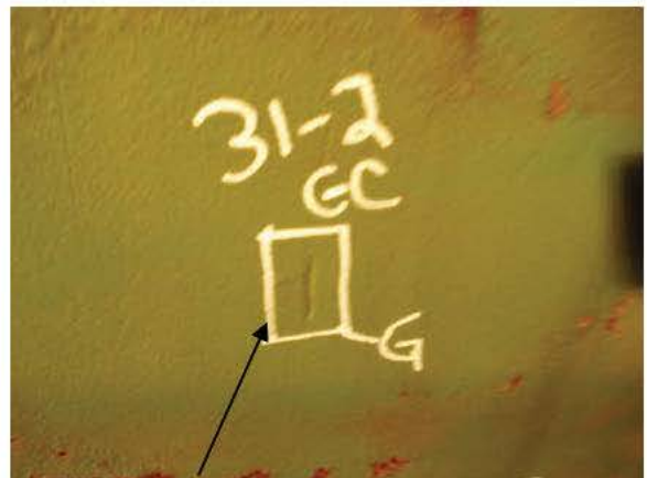
C-P31-2 GOUGE REPAIR
