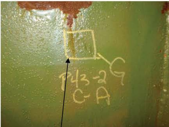
A-P43-2 GOUGE REPAIR
