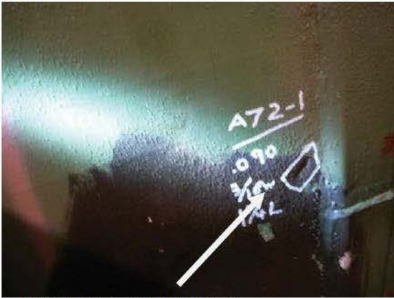
A-P72-1 GOUGE REPAIR
