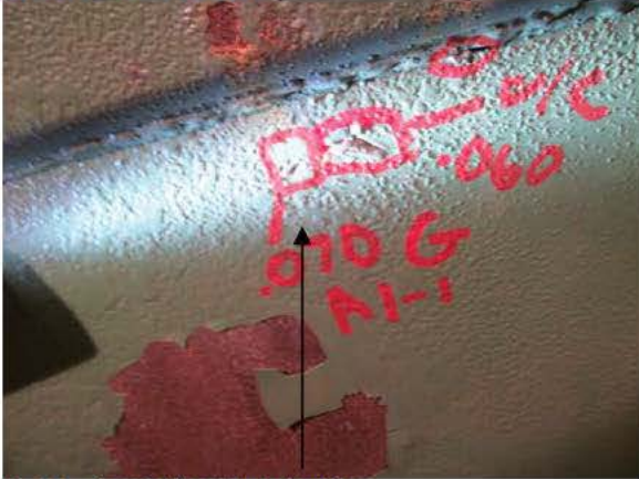
A-P1-1 GOUGE REPAIR
