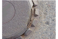
Broken spill bucket lid
