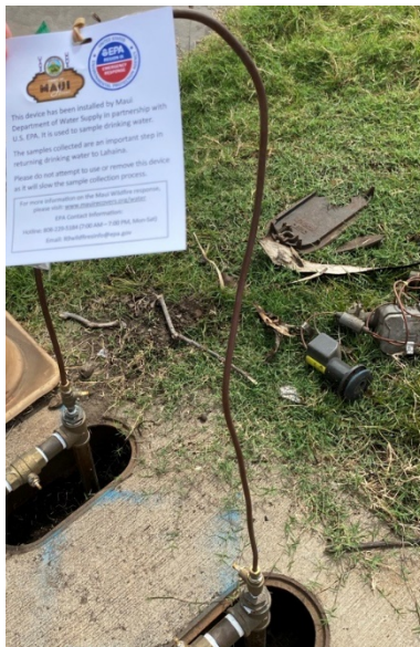
Figure 2. Ang meter box na may aparato at etiketa ng
